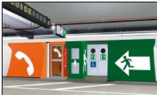
圖十三 A86 West Beltway Tunnels 之逃生標誌
